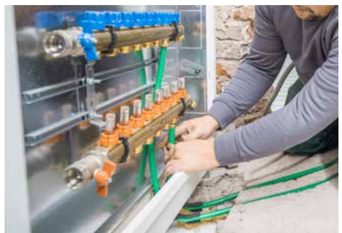
Anschluss der Fußbodenheizungsrohre an den Verteiler, Befüllung der Anlage mit Wasser und Dichtheitsprüfung.
