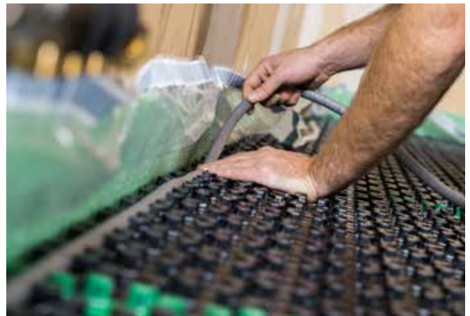
Die Verlegeplatten müssen seitlich zum Randdämmstreifen mittels Rundprofil abgedichtet werden, um ein Eindringen des Estrichs in die Randbereiche zu vermeiden.
