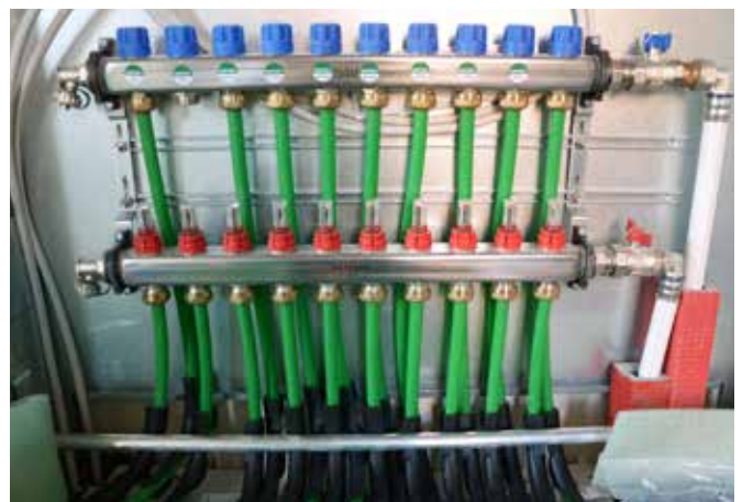
Nach Anschluss der Fußbodenheizungsrohre an den Verteiler erfolgt die Befüllung der Anlage mit Wasser und die Dichtheitsprüfung.
